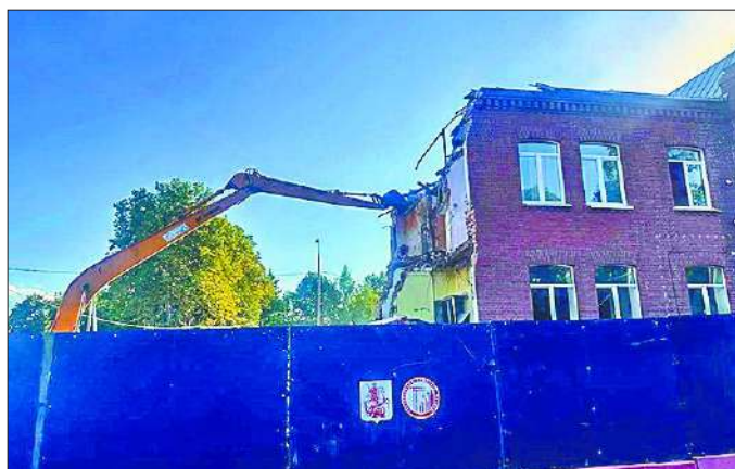
Стр. 2 – 4 миллиона на ремонт... снесённого дома
