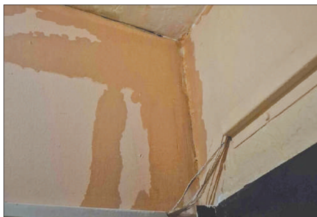
Стр. 4 – Отопление дали – подъезды затопило
